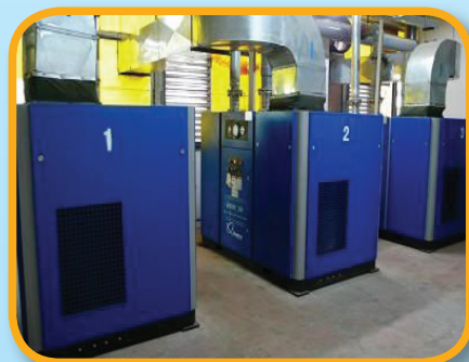
中央真空螺桿機組
