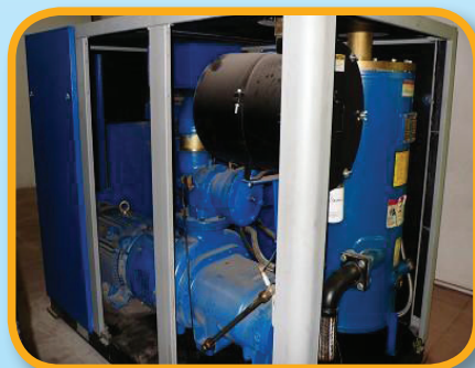
中央真空螺桿機組內部構造
